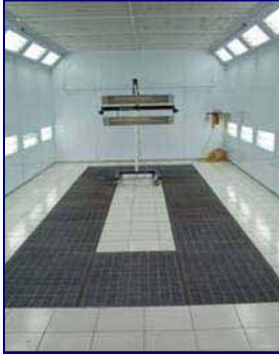
Gambar 17.8 Bagian dalam ruang cat ( Spray Booths )
