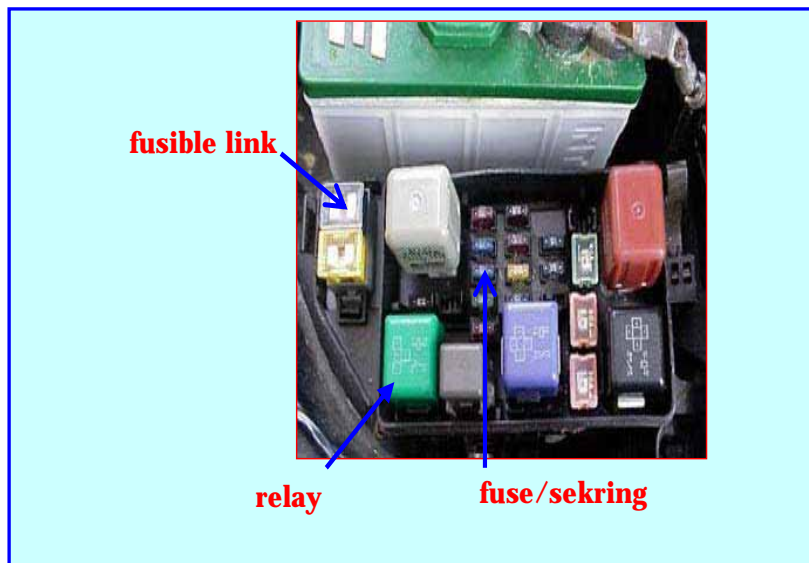
Gambar 16.7. Pengaman yang terdiri dari fusible link , relay dan fuse
