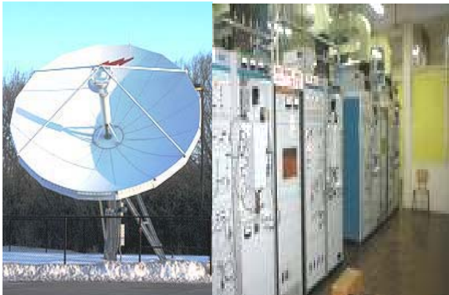
Gambar 65. Tower, antena parabola dan Ruang Pemancar
