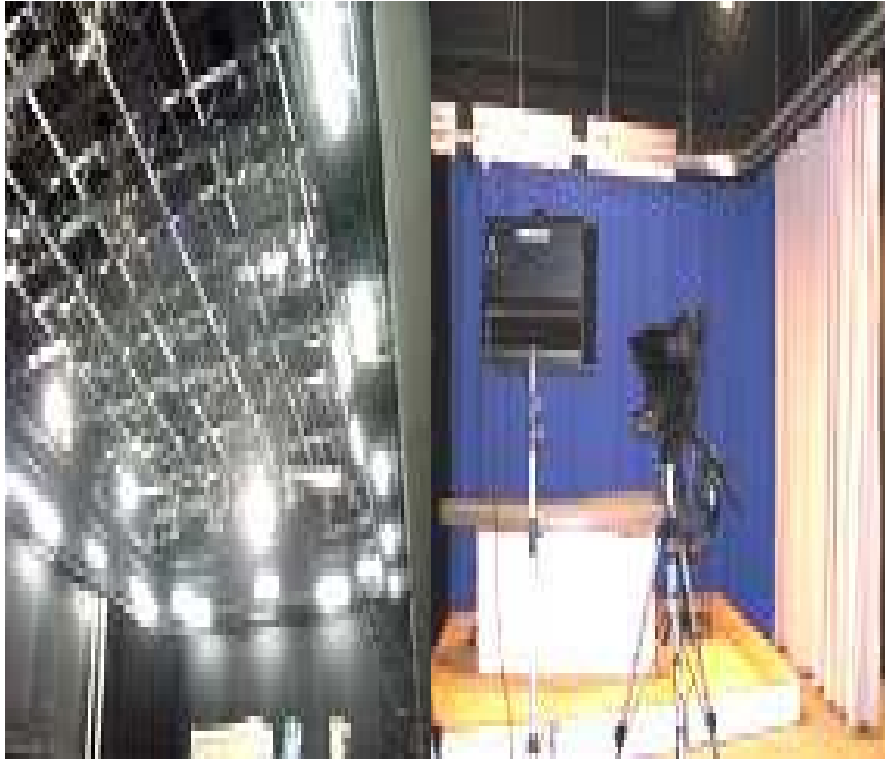
Gambar 76. Lampu Studio yang dipasang tetap di plafon dan lampu stand
