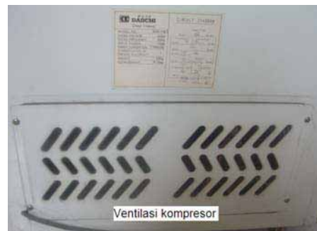
Gambar 3.92 Ventilasi udara ruang kompresor
