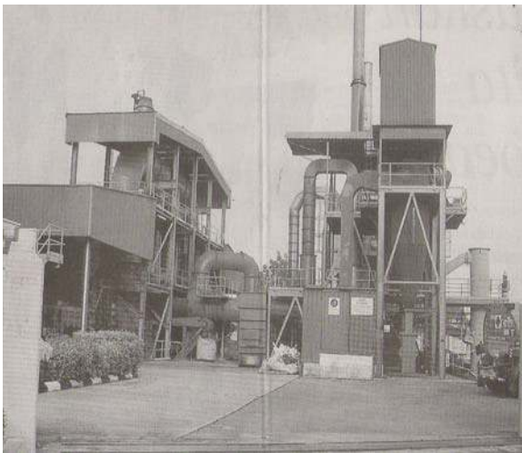
Gambar 2.13 : Instalasi Pemusnah Limbah yang Berbahaya (Sumber Ralph C. Bohn, 1986)
