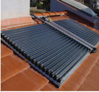
Sumber: greenoorjasolution.com Gambar 4.30 Permukaan pemanas air yang memanfaatkan panas matahari ( solar heating ) berwarna gelap atau hitam. Mengapa?
