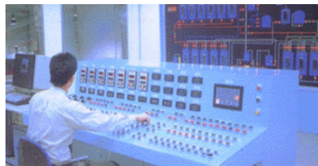
Gambar 1-7 Ruang Kontrol Otomasi
