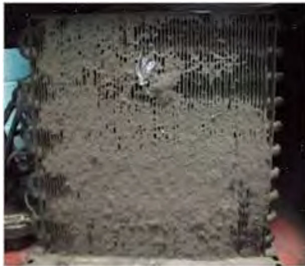
Gambar 4. 31 Kondisi Block condenser
