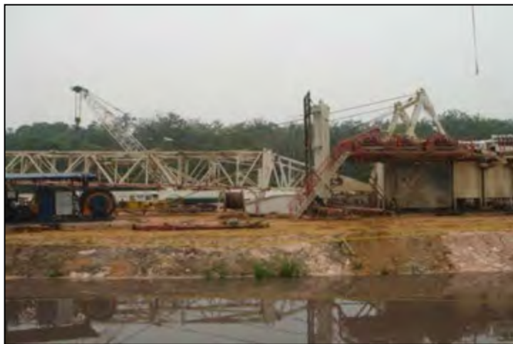
Gambar 2.11. Dasar dari Mast Diangkat ke Rig Floor
