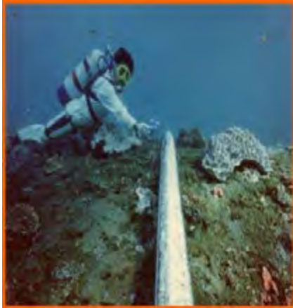
Gambar 4. 4.Kabel bawah laut 2. Saluran Isolasi Gas
