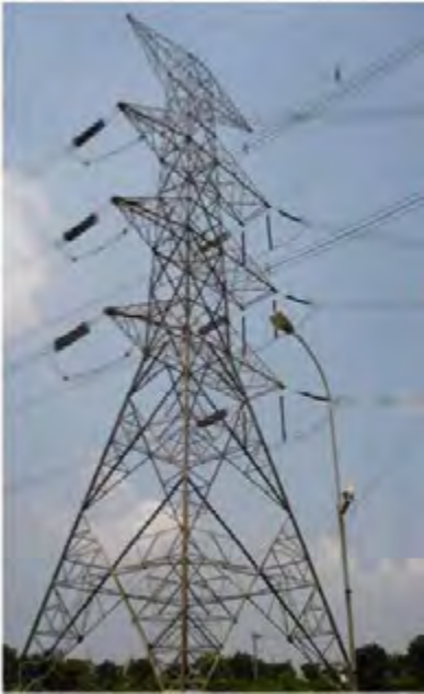
Gambar Isolator yang terpasang pada tension tower type DD
