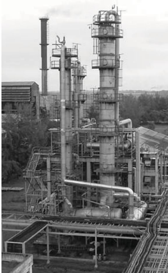
Gambar 4.71. Foto rangkaian alat distilasi di sebuah pabrik
